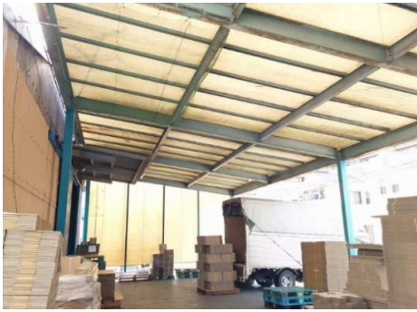
老朽化で雨漏りが認められたテント屋根
